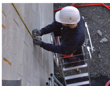
Protection de l'opérateur par garde-corps et chaînettes.
